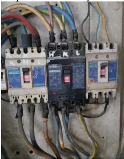
Gambar 9 Gambar Panel Tanpa Thermal
