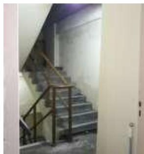
Gambar 11. Kondisi Tangga pada Rusunawa Jatinegara Barat
