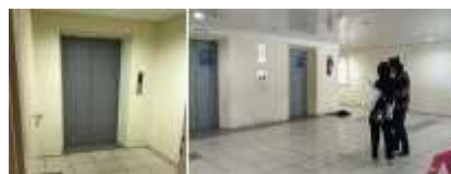
Gambar 12. Kondisi Lift pada Rusunawa Jatinegara Barat
