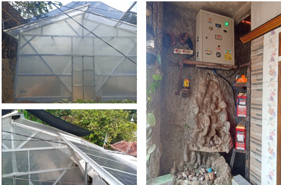
GAMBAR 1. Sistem PLTS pada Greenhouse di Kampung Langkop, Desa Majalaya, Cikalongkulon, Cianjur
