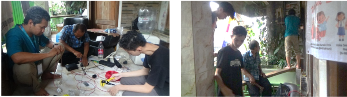
GAMBAR 5. Instalasi perangkat monitoring energi berbasis IoT untuk PLTS
