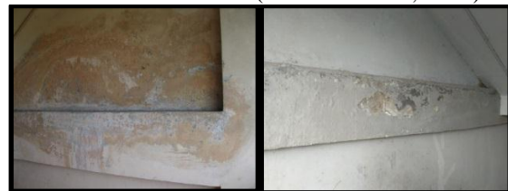
Gambar 3 Dinding yang Bernoda & Lembab Blok A & Blok B (Data Penelitian, 2016)
