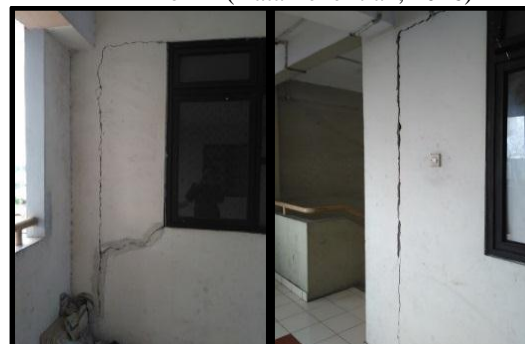
Gambar 4 Dinding yang Retak Blok A & Blok B (Data Penelitian, 2016)
