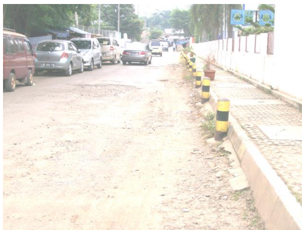
Gambar 2. Kondisi Jalan Swadaya PLN
