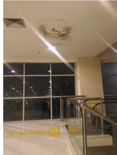
Gambar 1. Kerusakan Pada Plafon
