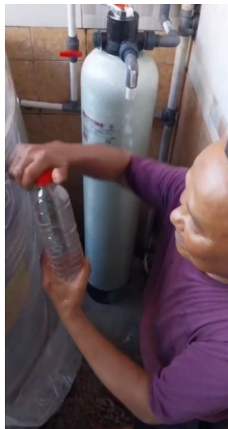
Gambar 3. Kegiatan Pendampingan Pemasangan Sistem Pengolahan Air Wudhu menjadi Air Siap Minum
