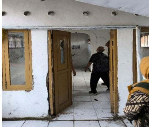
Gambar 1. Kondisi Bangunan Musholla
