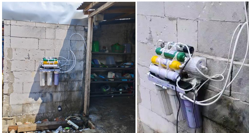
Gambar 3. Mesin RO yang Terpasang di Lokasi Mitra Pondok Pesantren Darul Muttaqin, Kota Batu, Jawa Timur
