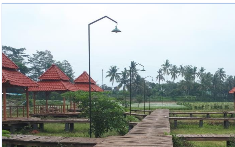
Gambar 15 PLTS untuk penerangan terpasang
