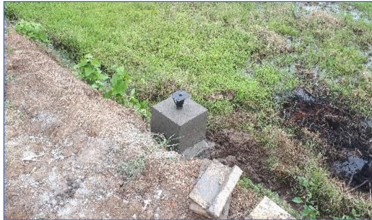
Gambar 8. Dudukan tiang lampu
