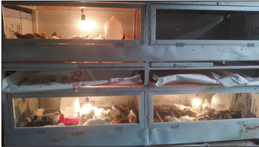
Gambar 6. Suplai Listrik Sistem PLTS pada Lampu Bohlam 15 W.
